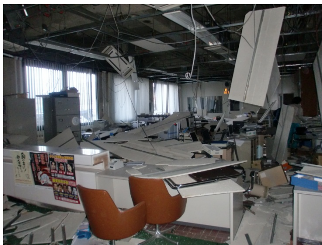
役場庁舎も大きな被害を受けた（1階窓口）
