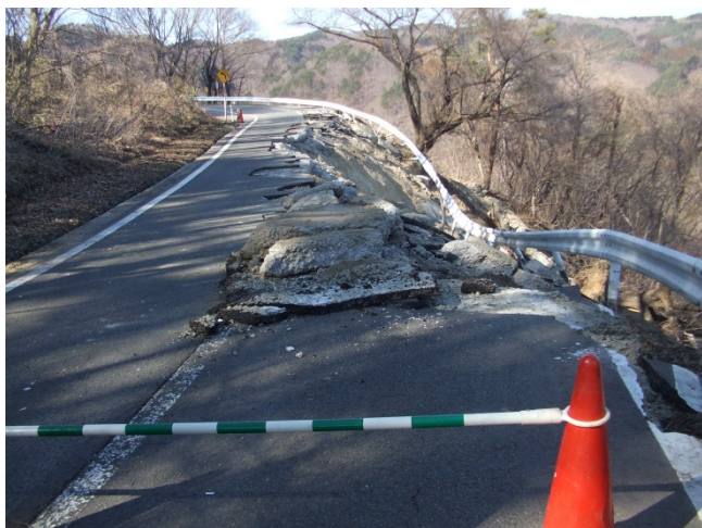
町内各所で道路が寸断した
