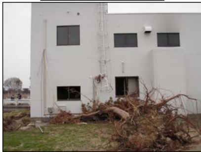
施設損壊状況
