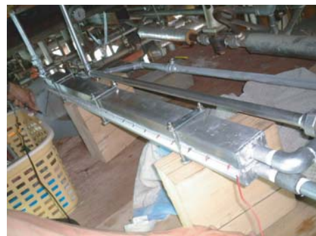
北海道釧路市中島町における 温度差発電事例
