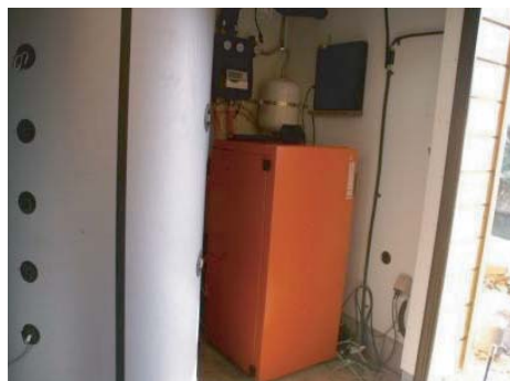
和歌山県田辺市におけるバイオマス利用の事例 左側が蓄熱タンク 右側がペレットボイラー
