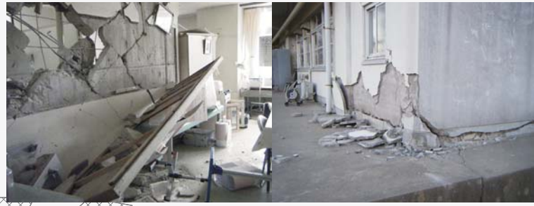
□七ヶ浜中学校の被災状況
