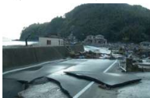
▼ 断絶した北上地区の道路
