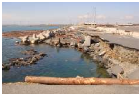
▼被災した雲雀野海岸堤防
