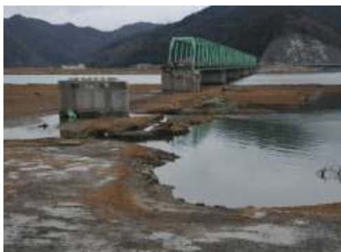
▼新北上大橋の落橋
