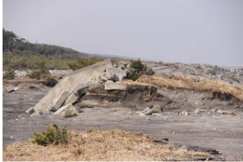
▲地震発生翌日の防波堤の状況
