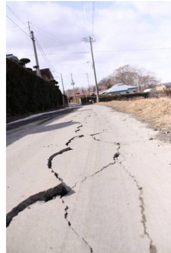
▲地震発生翌日の道路状況
